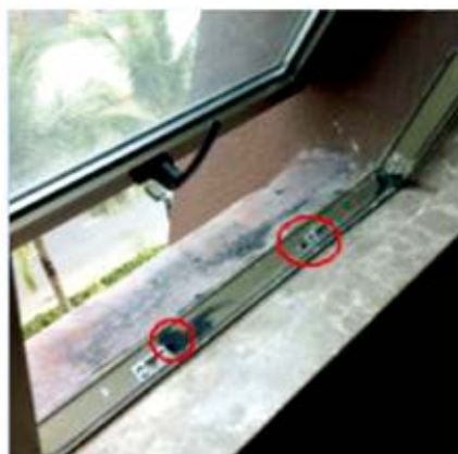
现象:幕墙是窗型材变形,五金无法使用,采用插销锁闭
