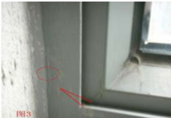
现象:窗扇与窗框之间在关闭转台下方间隙过大,漏风、漏水
