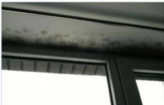
现象：室内屋顶墙管发霉
