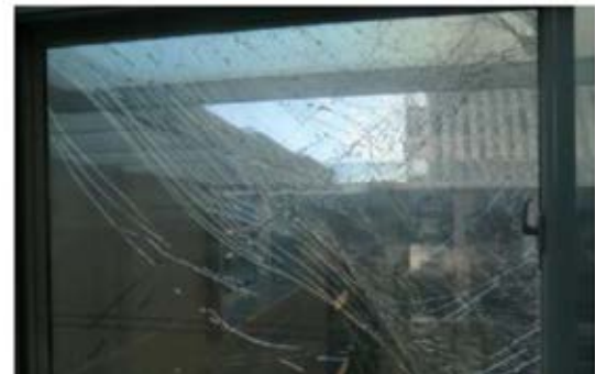
现象：半钢化玻璃炸裂
