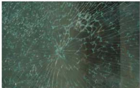
现象：钢化玻璃炸裂—非自爆
