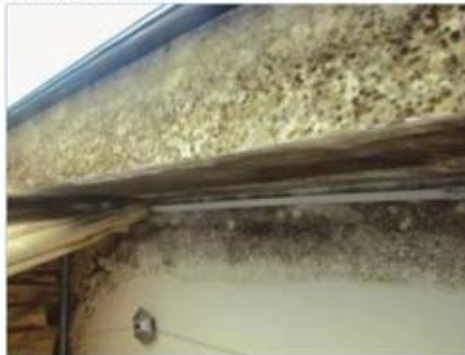
现象：室内屋顶墙管发霉
